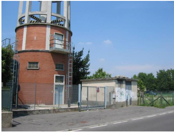
Impianto tecnologico – Via Dante Alighieri
