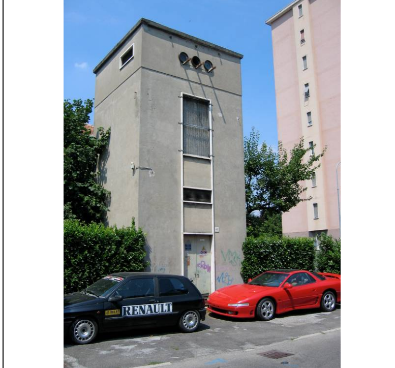
IT04 Impianto Tecnologico Via Rimembranze
