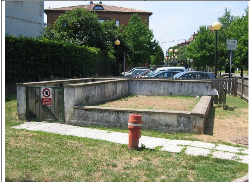
IT05 Impianto Tecnologico Via Italia
