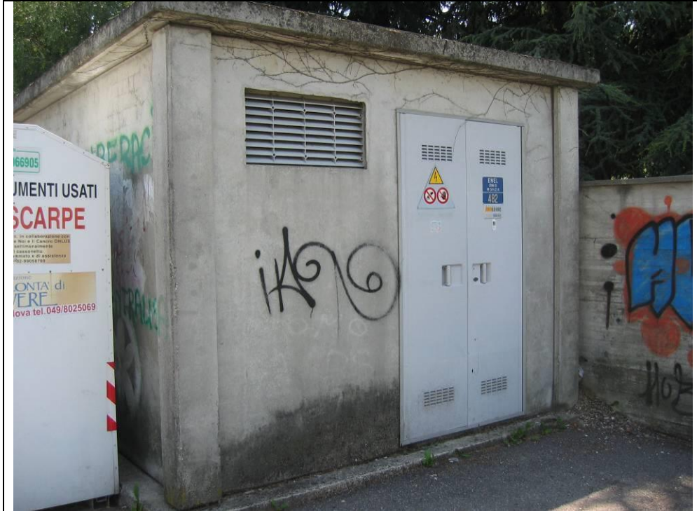
IT08 Impianto Tecnologico Via della Misericordia
