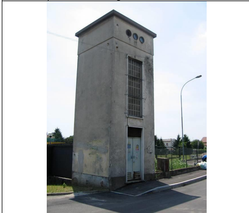
IT09 Impianto Tecnologico Via Leonardo da Vinci
